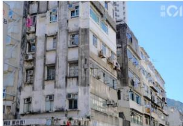
市面樓宇老化問題嚴重，樓齡達50年或以上，於閣樓已掛一層樓，後於閣樓維修或易損壞。(資料圖片/香港房屋)
